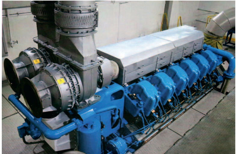
Рис. 5. Дизель-генератор 12ЛДГ500 мощностью 4 412 кВт (6 000 л.с.)
