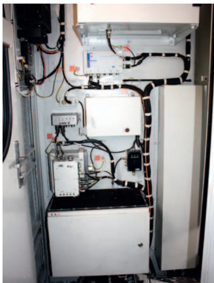
Рис. 4а. Размещение оборудования в аппаратном помещении
