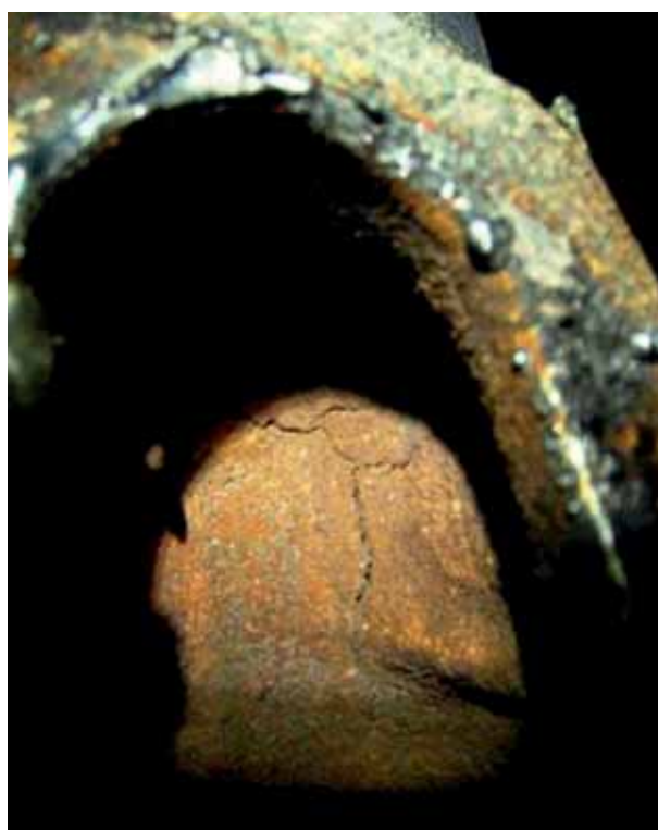
Рис. 4. Фрагмент отливки «Рама боковая» с горячей трещиной
